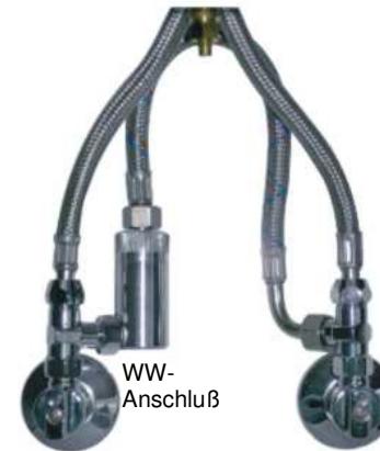
Foto: Unter einem Waschbecken eingebauter Zirkulationsregler
